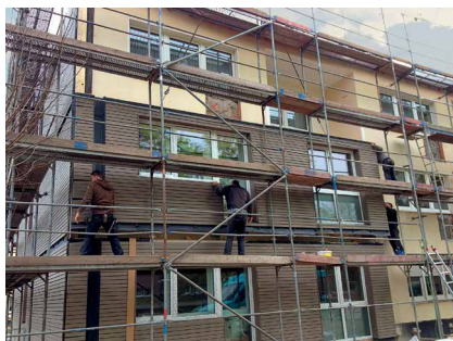
Abb. 3: Die vorproduzierten Bauelemente können auf der Baustelle schnell und sicher montiert werden.
